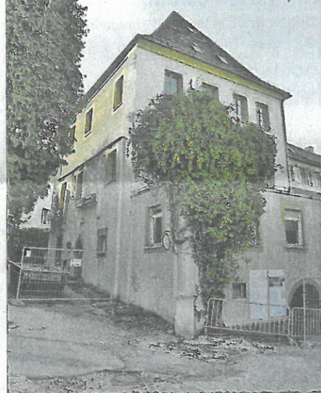
Der unpassende Vorbau des Baudenkmals soll abgebrochen werden.
