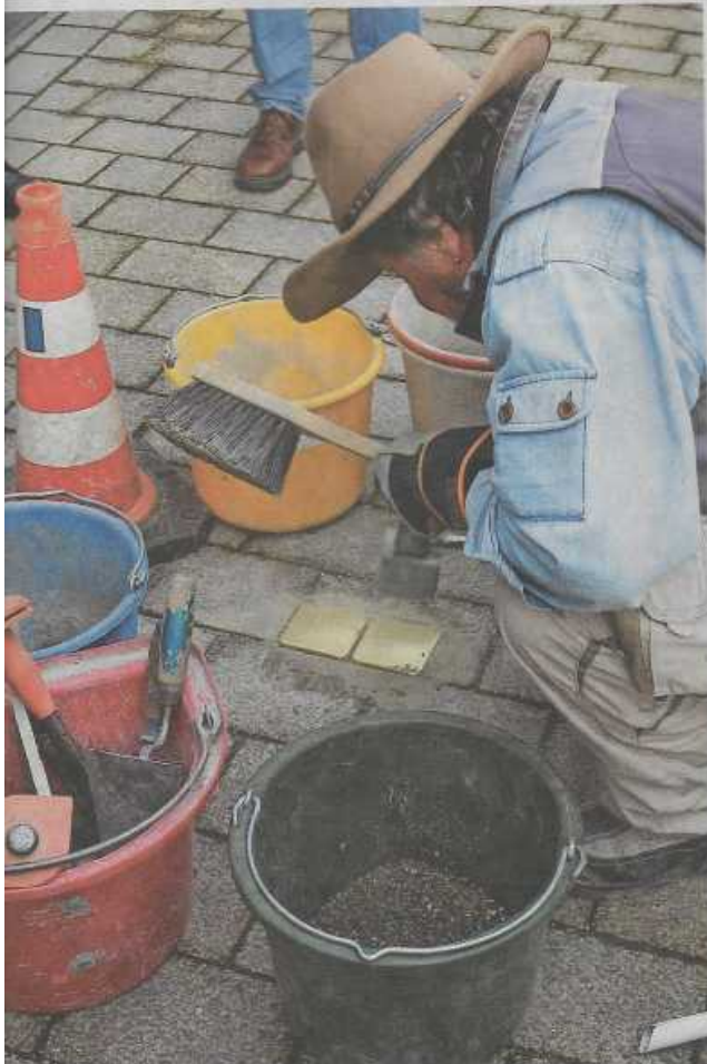
Nur wenige Minuten braucht Gunter Demnig für das Verlegen der einzelnen Steine. Die Stadt hatte bereits vergangene Woche die Löcher vorbereitet.
