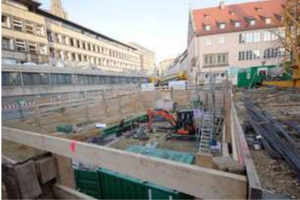
Lange tat sich auf der Baustelle der neuen Synagoge am Weinhof wenig, jetzt werden die Fundamente gelegt. (Foto: nuz)
